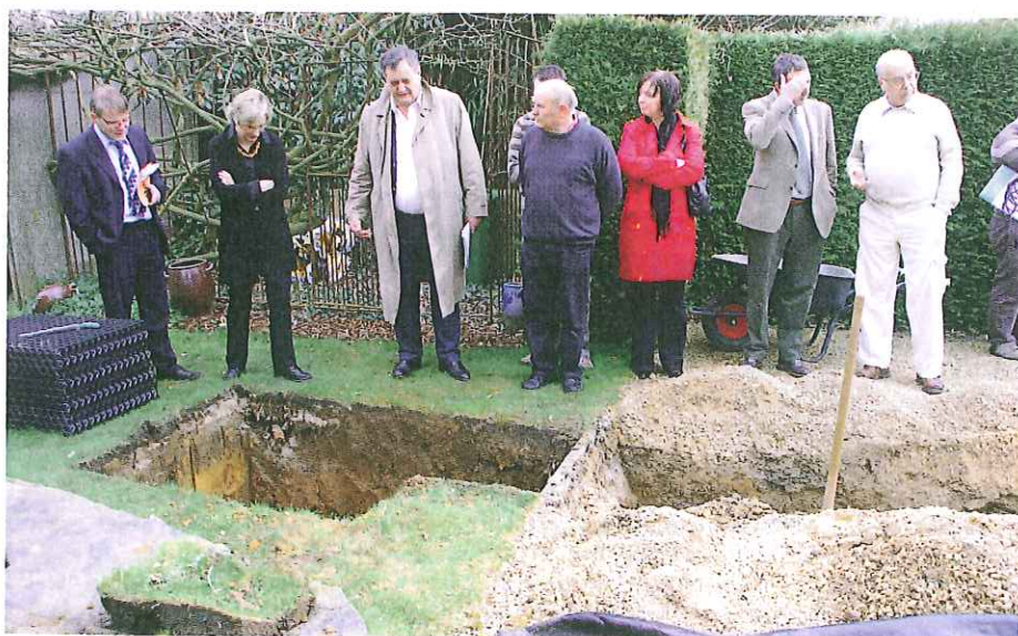
De Herentse eerste schepen Jos Bex (derde van l.) bekeek samen met Vlaams minister Crevits (tweede van l.) o.m. deze werken voor een infiltratieput in een plaatselijke tuin. Ook burgemeester Willy Kuijpers (r.) was van de partij.
